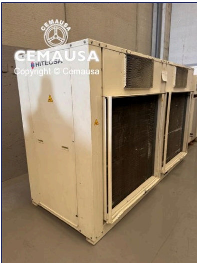
Grupo refrigeración agua 69,8 Kw. HITECH EWCBZ 3002 Ref: CEM-26047
