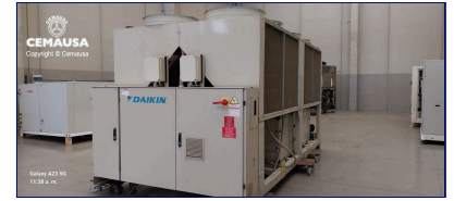
Grupo refrigeración agua 368 Kw.316480 frigorías/h DAB EWYD360AJYNN Ref: CEM-26017
