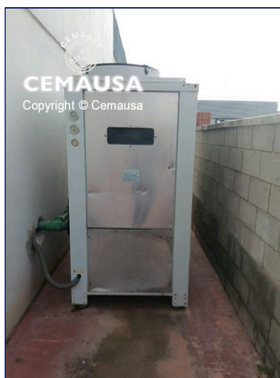
Grupo refrigeración agua 68000 frigorías/h. EQUIFAB ESE. 095/CS Ref: CEM-25033
