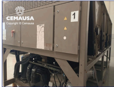
Grupo refrigeración agua 451 Kw. 387000 frig/hora YORK YLAA0455 HE50XAA Ref: CEM-26009
